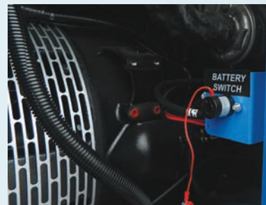
1 12 Volt battery isolator switch
